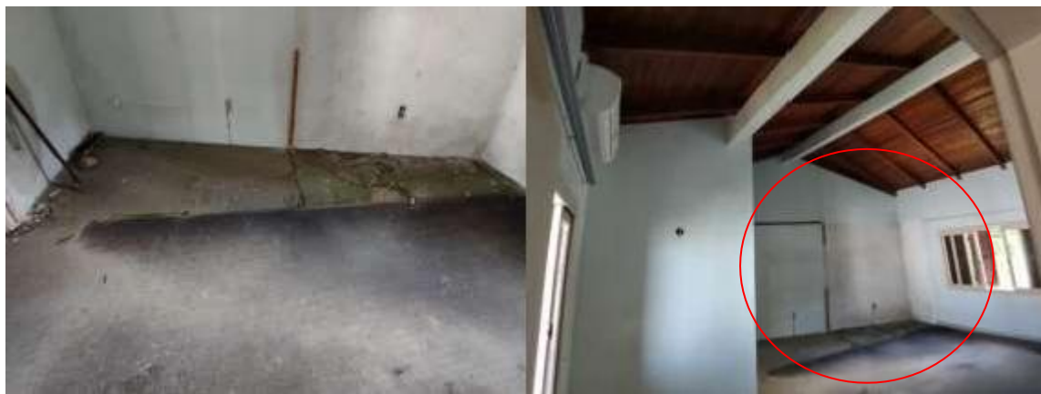
Figura 25 – ÁREA INTERNA – EDIFICAÇÃO PRINCIPAL: Trechos de carpete descolados, manchados e rasgados, necessário remoção ou substituição do mesmo. Pintura das alvenarias desgastada, necessário repintura geral.
