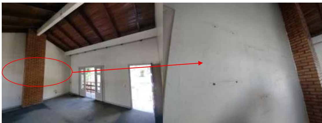
Figura 26 – ÁREA INTERNA – EDIFICAÇÃO PRINCIPAL: Furos proveniente da fixação de equipamentos/prateleiras, necessário realizar calafetagem dos furos e repintura geral.
