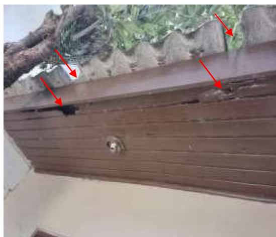
Figura 14 – ÁREA EXTERNA-EDÍCULA-FACHADA PRINCIPAL: Telhas de beiral quebradas, indícios de apodrecimento de forro devido a incidência de águas das chuvas. Necessário substituição do forro de beiral em trechos específicos. Recomendamos a poda ou
