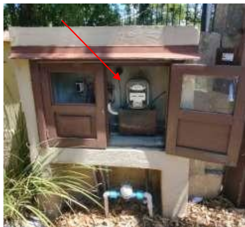
Figura 3 – ÁREA EXTERNA – ENTRADA DE ENERGIA: Entrada de energia fora dos padrões normativos, necessário adequações.
