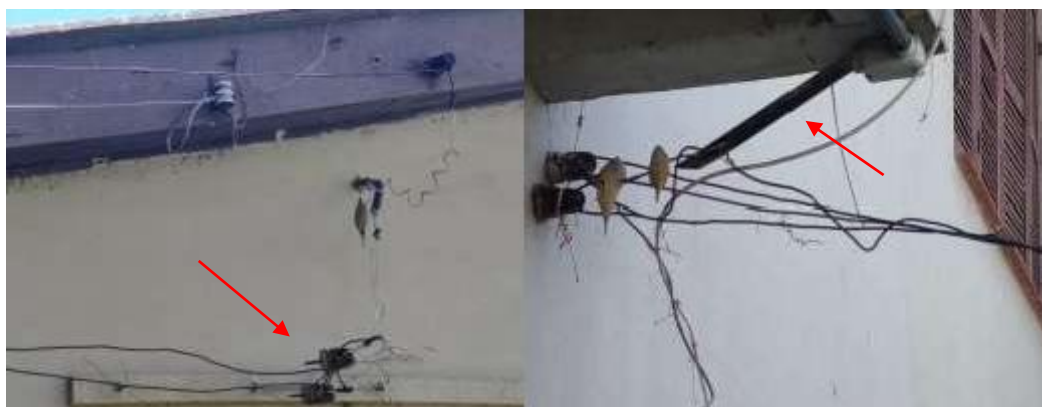
Figura 4 – ÁREA EXTERNA FUNDOS – CABOS E FIOS: Cabos e fios soltos, instalações fora dos padrões normativos, necessário adequações.
