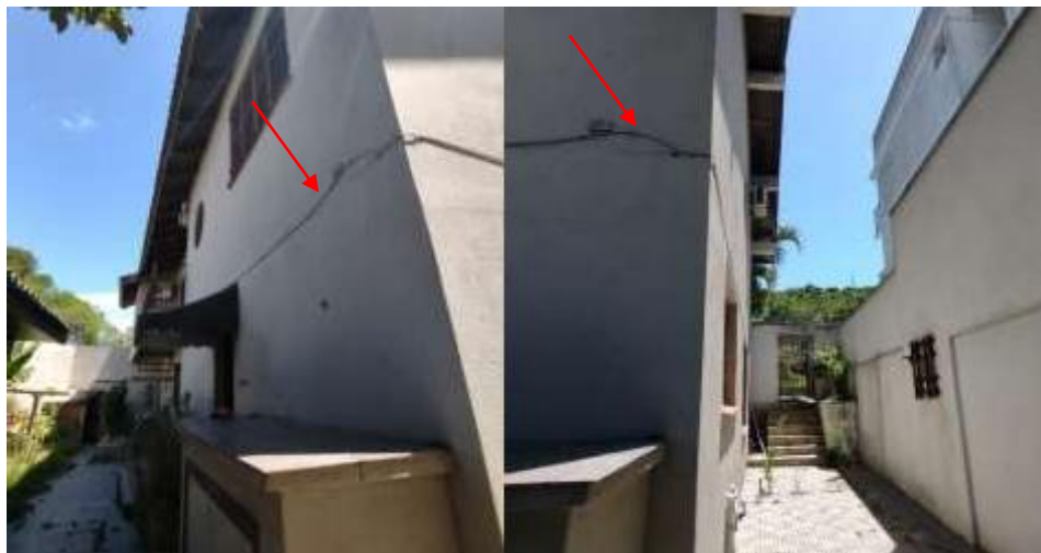
Figura 10 – ÁREA EXTERNA - TOLDO: Elemento de cobertura existente danificado.
