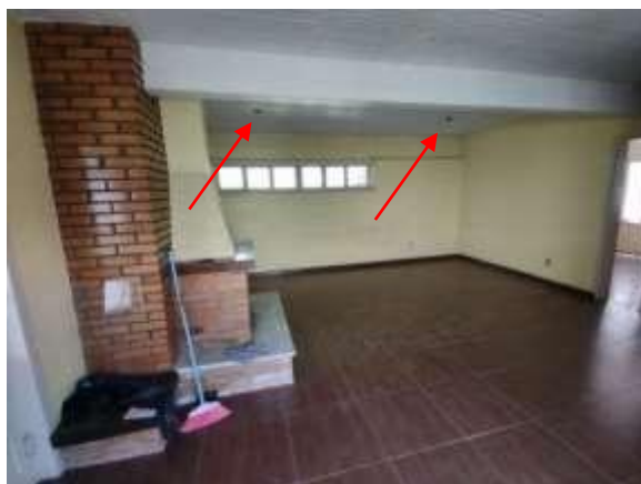
Figura 29 – ÁREA INTERNA – EDIFICAÇÃO PRINCIPAL: Ausência de luminárias necessário reposição dos
