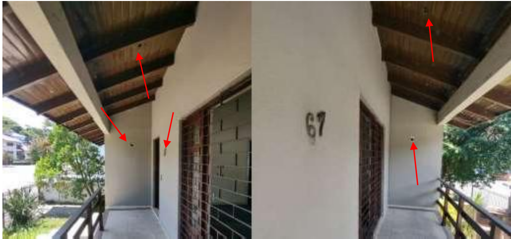
Figura 6 – ÁREA EXTERNA – FACHADA PEINCIPAL: Ausência de luminárias ou acabamento em pontos de luz, necessário reposição dos elementos ou fechamento com tampas cegas.
