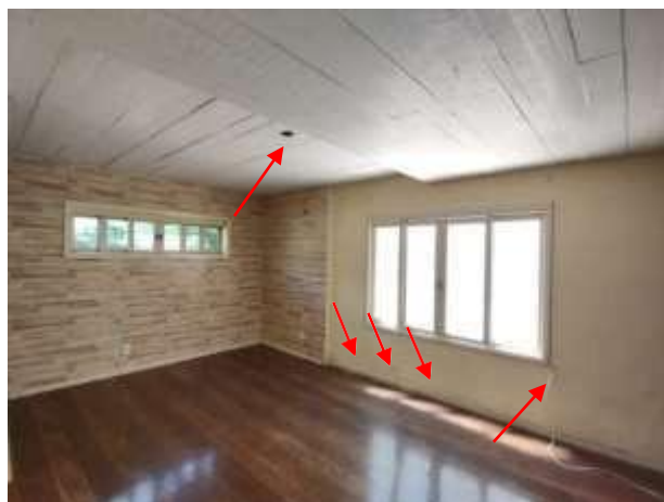
Figura 28 – ÁREA INTERNA – EDIFICAÇÃO PRINCIPAL: Ausência de luminárias, cabos soltos, necessário reposição e correta fixação dos cabos. Indícios de umidade por capilaridade na altura dos rodapés, necessário verificação da integridade do revestimento argamassado (reboco), caso necessário refazimento dos trechos.
