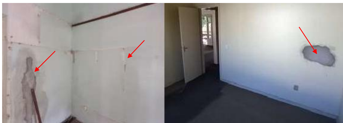
Figura 24 – ÁREA INTERNA – EDIFICAÇÃO PRINCIPAL: Avarias no revestimento argamassado (reboco), e indícios de correções realizadas, necessário conclusão para posterior repintura das alvenarias.
