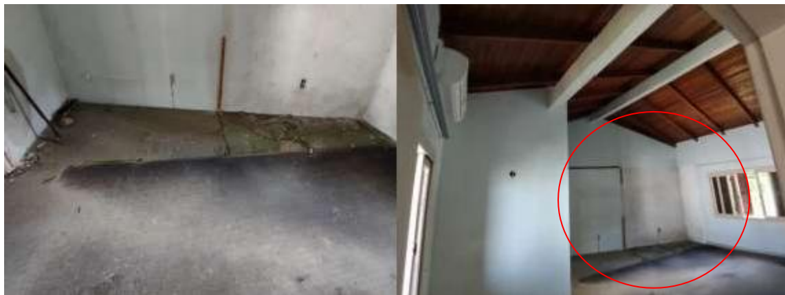
Figura 25 – ÁREA INTERNA – EDIFICAÇÃO PRINCIPAL: Trechos de carpete descolados, manchados e rasgados, necessário remoção ou substituição do mesmo. Pintura das alvenarias desgastada, necessário repintura geral.
