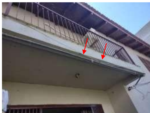
Figura 12 - ÁREA EXTERNA-EDIFICAÇÃO PRINCIPAL – FACHADA DOS FUNDOS: Remover e/ou realizar
