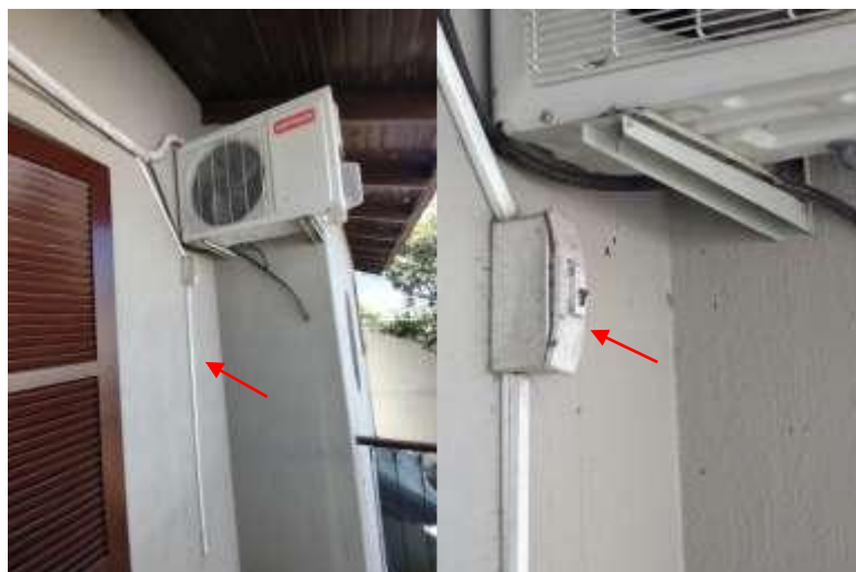
Figura 5 – ÁREA EXTERNA – AR CONDICIONADO: Instalações inadequadas dos equipamentos, necessário correção conforme padrões normativos.
