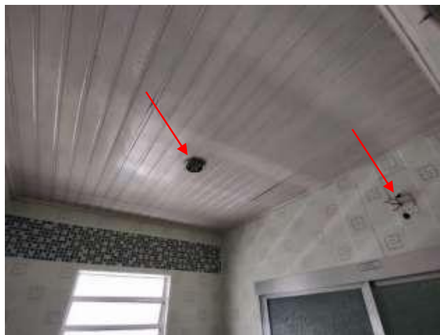
Figura 23 – ÁREA INTERNA – EDIFICAÇÃO PRINCIPAL-SANITÁRIO: Ausência de equipamento chuveiro elétrico e luminária, necessário reposição.
