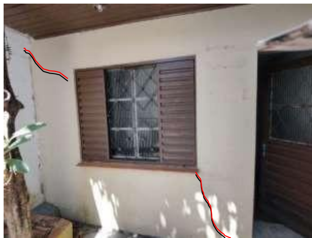
Figura 15 – ÁREA EXTERNA-EDÍCULA-FACHADA PRINCIPAL: Trincas e fissuras nas alvenarias internas/externas da edificação, indicativo de movimentações estruturais, necessário acompanhamento das aberturas das fendas para posteriortratamento adequado.
