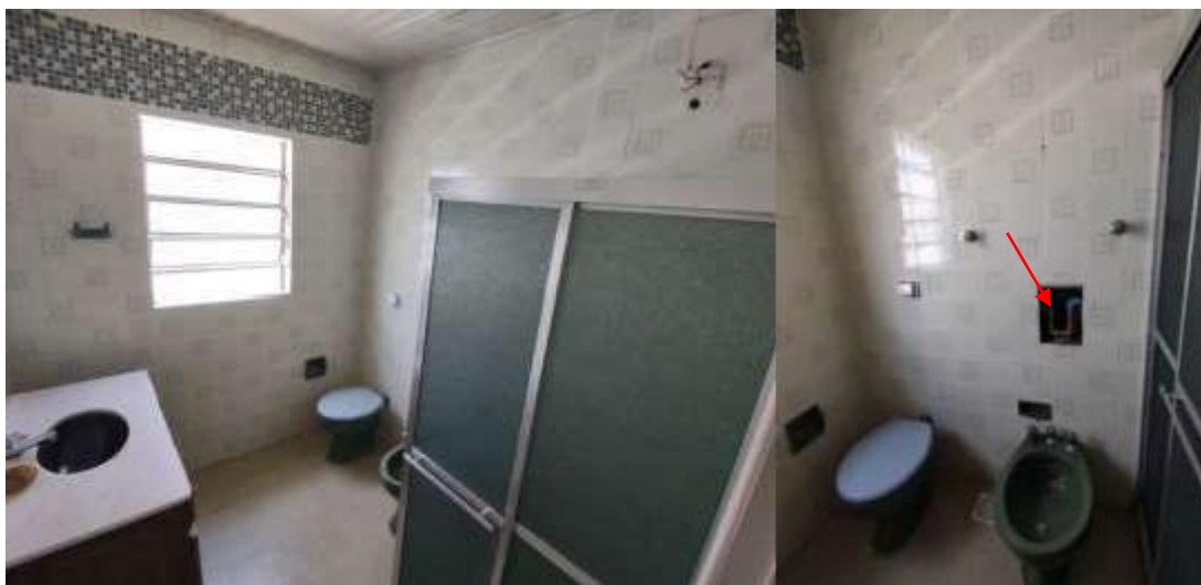
Figura 21 – ÁREA INTERNA – EDIFICAÇÃO PRINCIPAL-SANITÁRIO: Louças originais existentes, tubulação exposta recomenda-se o fechamento do vão e posterior revestimento cerâmico.
